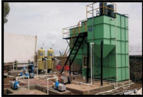
Effluent Treatment -PLANT
